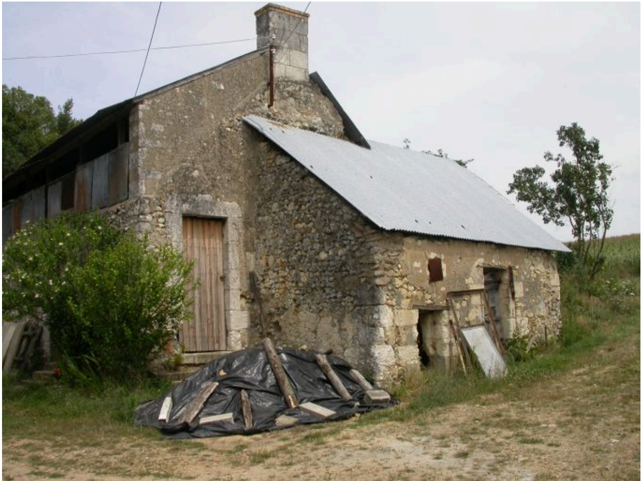
Maison 1, pignon sud : l'appenti du four à pain. Remarquer le changement de pente de la toiture ouverte pour le fenil.
