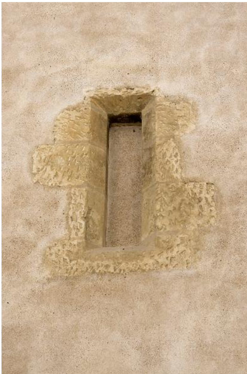
Logis sud-ouest (B), élévation sur rue, extrémité droite, 1er étage : petite baie murée.
