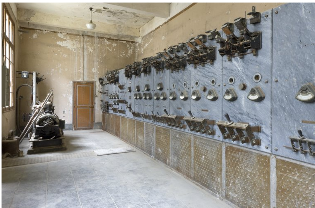
Prieuré de la Madeleine, transformateur électrique (époque pénitentiaire, 2e quart XXe siècle), intérieur.
