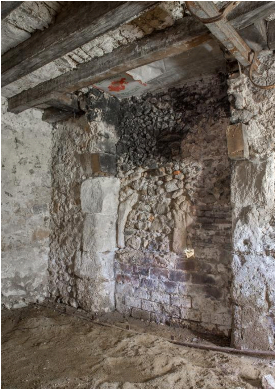
Intérieur, chambre à feu est, détail : vestiges de la cheminée. Four à pain détruit.
