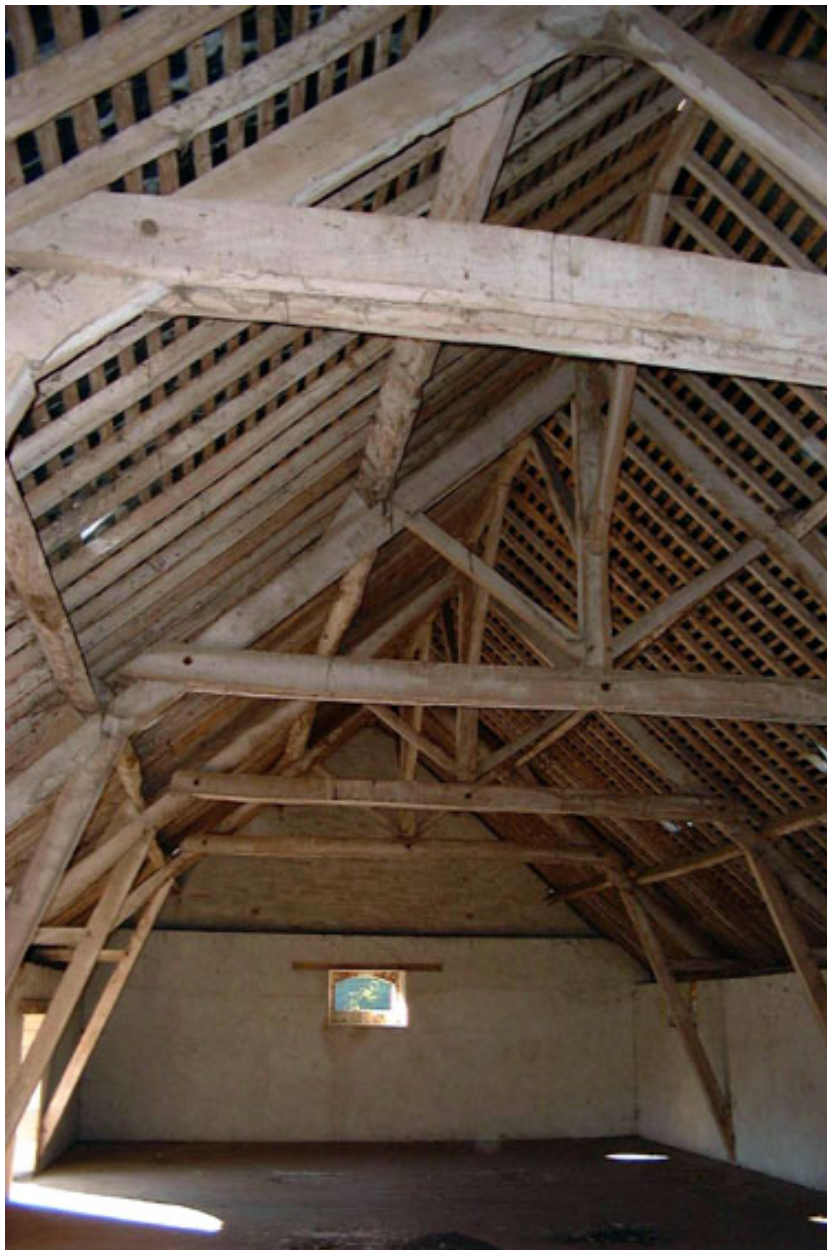
Charpente de la 2e moitié du 19e siècle ou du début du 20e siècle.
