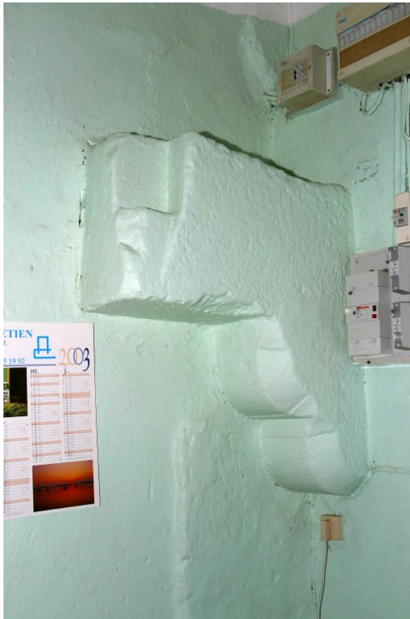
Le logis, vue intérieure. Corbeau nord de la cheminée détruite.
