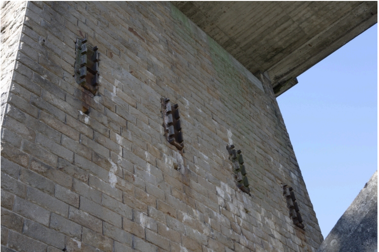
Anciennes agrafes du pont métallique détruit en 1944.
