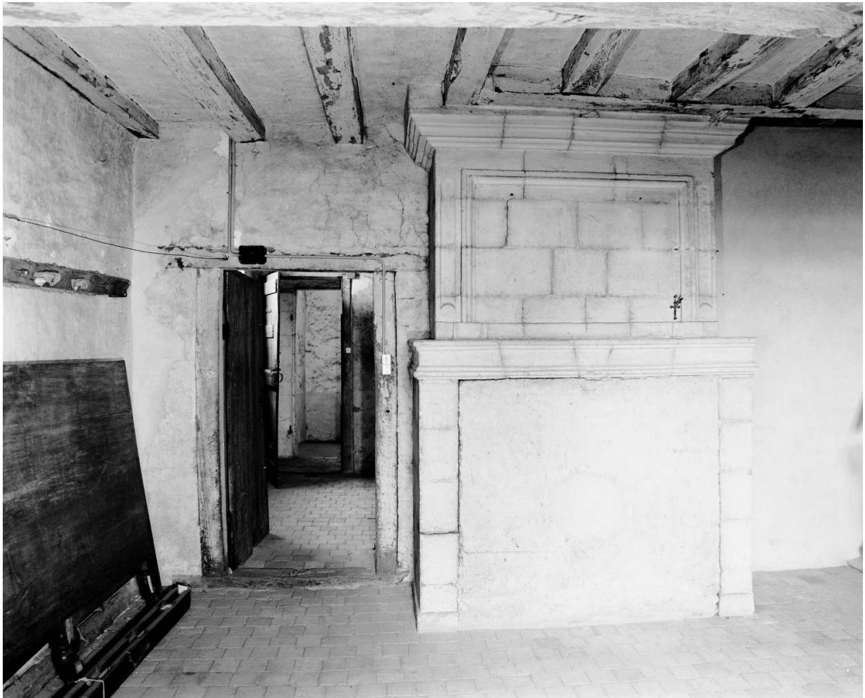
Bâtiment dit des lieux communs, pièce d'entresol au-dessus de la 1ère boulangerie (plan 1796), mur est : cheminée.
