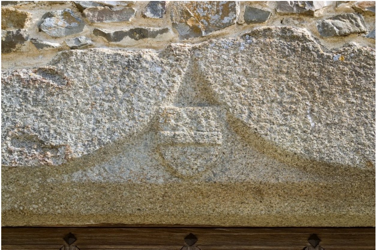
Façade principale du logis. Détail de la porte d'entrée sur la tour : l'arc et l'écusson.
