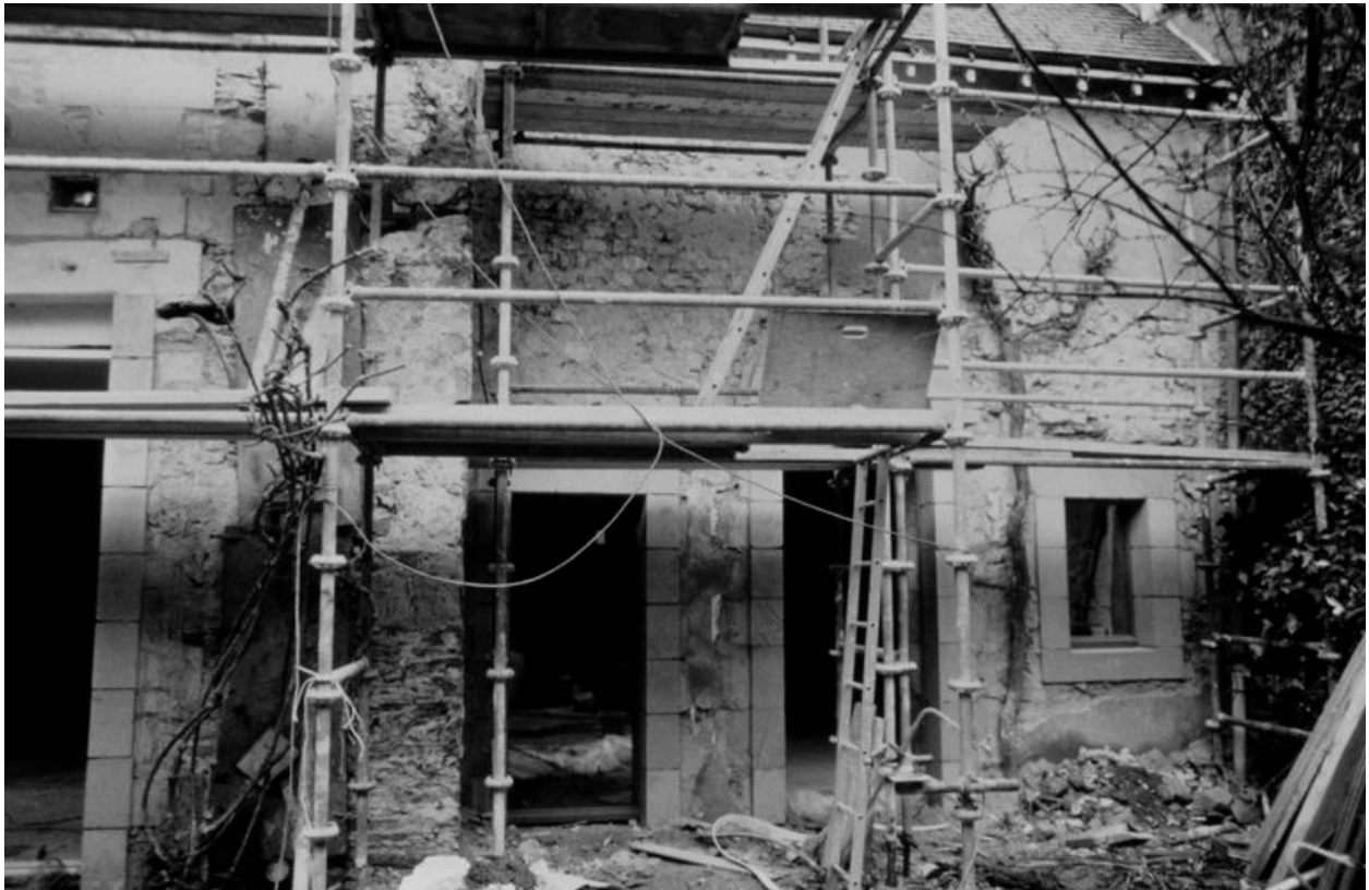
Choeur, élévation extérieure sud (sur cour) : vue d'ensemble, pendant les travaux de ravalement de février-mars 1997. La partie supérieure de la baie en plein cintre est masquée par l'échafaudage. A gauche, emplacement de la nef.
