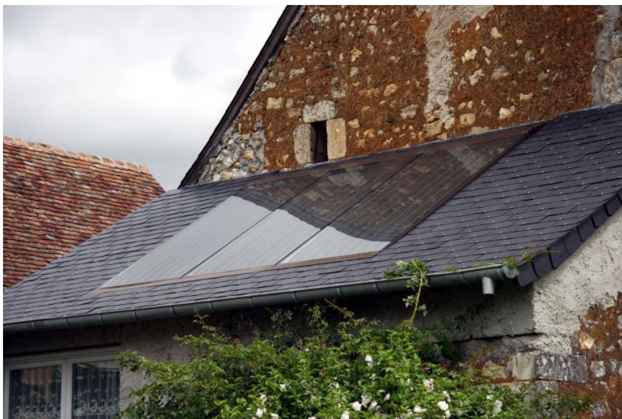
Pignon du moulin : chauffage solaire.
