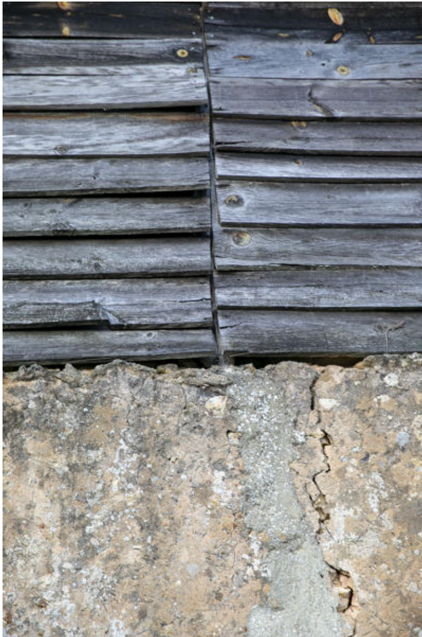
Un détail de mise en oeuvre pierre et bardage de bois, rue du Gué Hubert.
