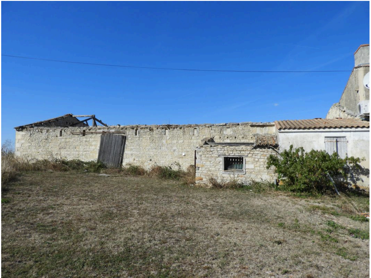
Les vestiges de la grange-étable au sud du logis, vus depuis l'est.
