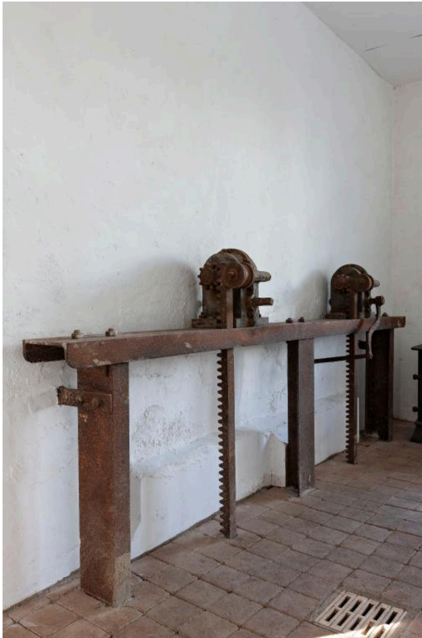
Rez-de-chaussée, partie nord, en 2019 : vannes d'amont.
