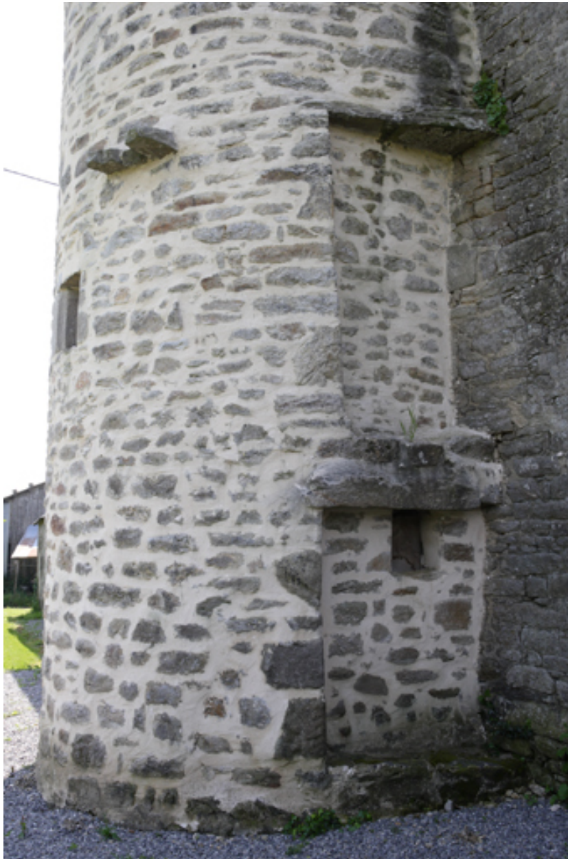
Logis. Tour d'escalier. Détail de la porte d'entrée et de la porte donnant sur la galerie.
