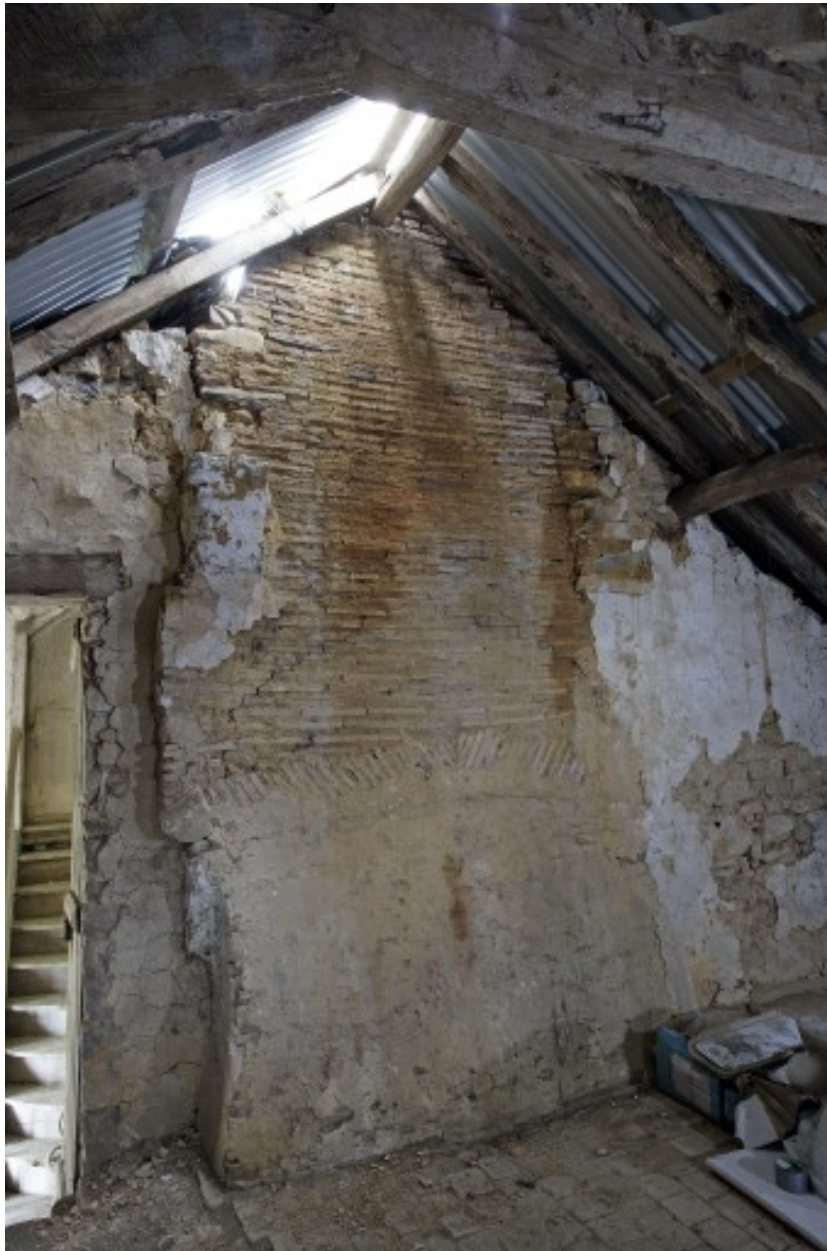
Le logis manorial, comble de la partie centrale : le mur de refend vu depuis le sud, avec le conduit de cheminée.
