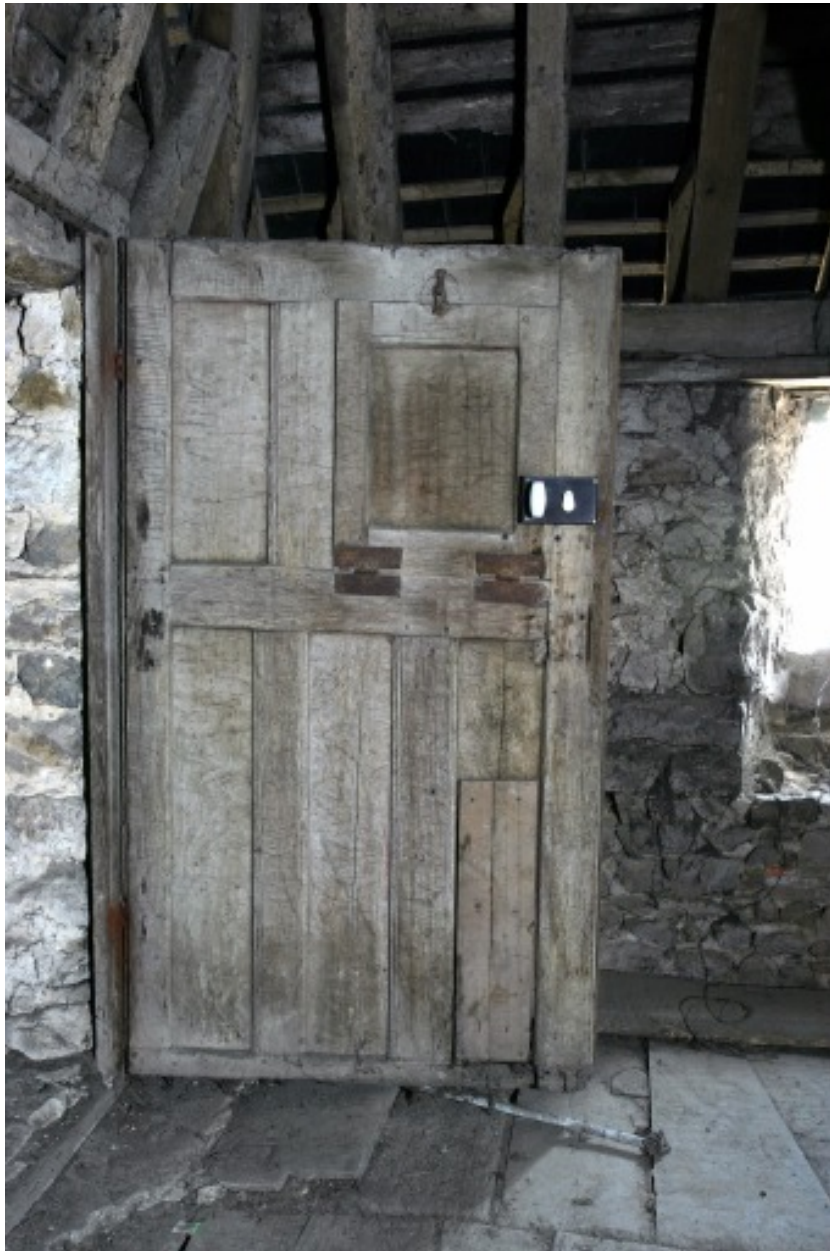
Comble de la cage d'escalier : la porte d'accès au comble de la partie nord, face intérieure.
