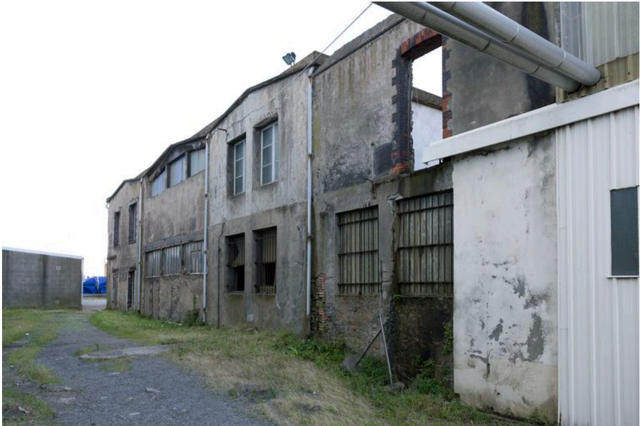
I : façade latérale des vestiaires, bâtiment construit au début du XXe siècle désaffecté.
