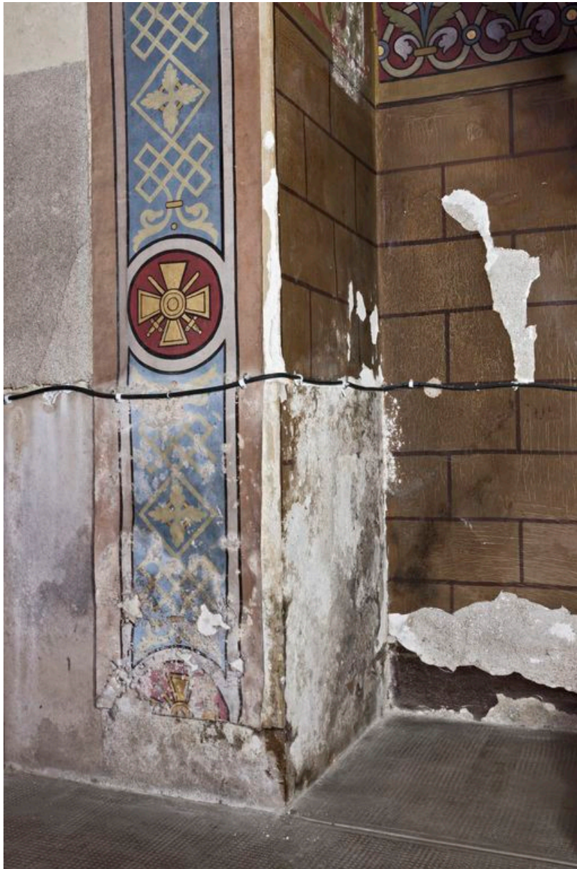
Nef, bas-côté nord. Monument aux morts, détail de la partie gauche en mauvais état de conservation.
