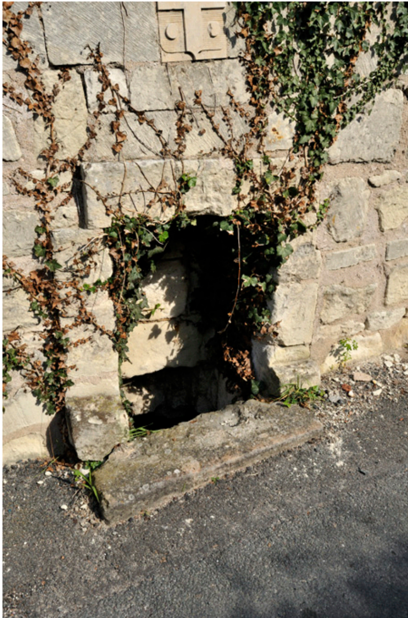
Ruelle de la Motte : jetée de pressoir aboutissant dans la salle sud-ouest.
