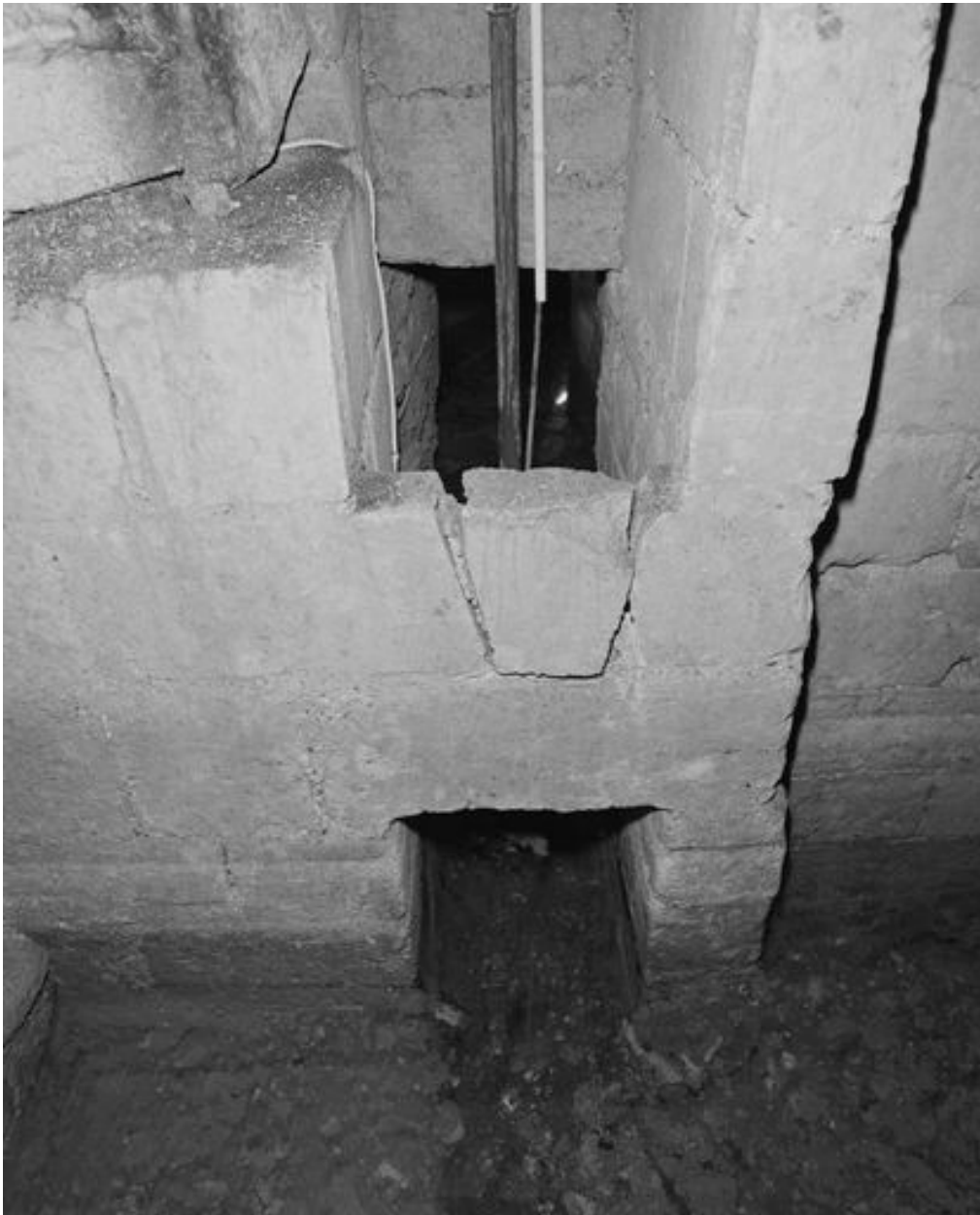
Sous-sol, système hydraulique, détail des canalisations.
