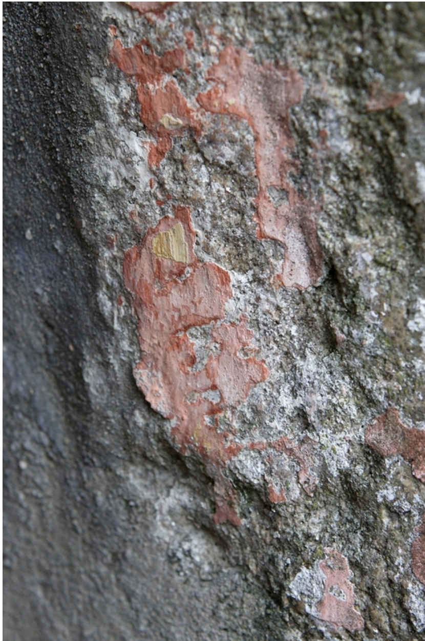
Détail des différentes couches de décor sur la porte d'entrée du logis (10 route des Marais).
