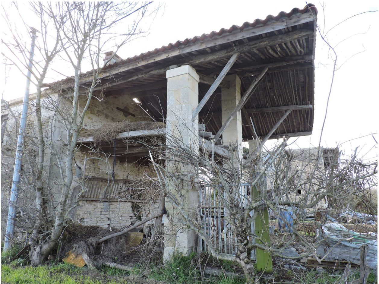
Le balet dans le prolongement nord du logis, vu depuis l'est avant sa démolition fin 2020.
