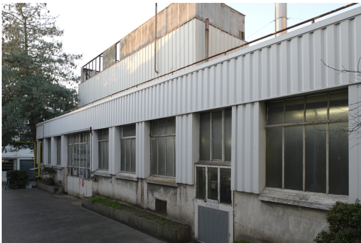
Chaufferie, construite en 1945
