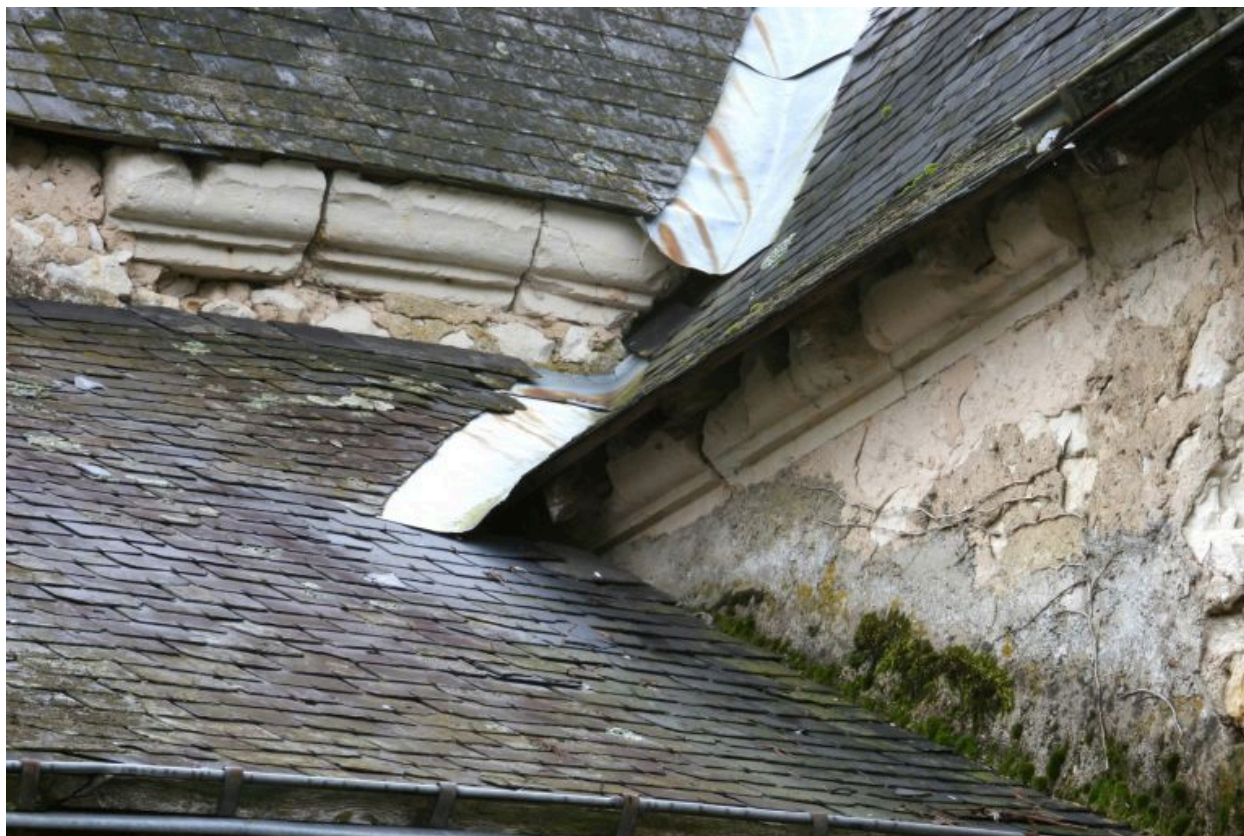
Les communs, face nord : vestige de la corniche.
