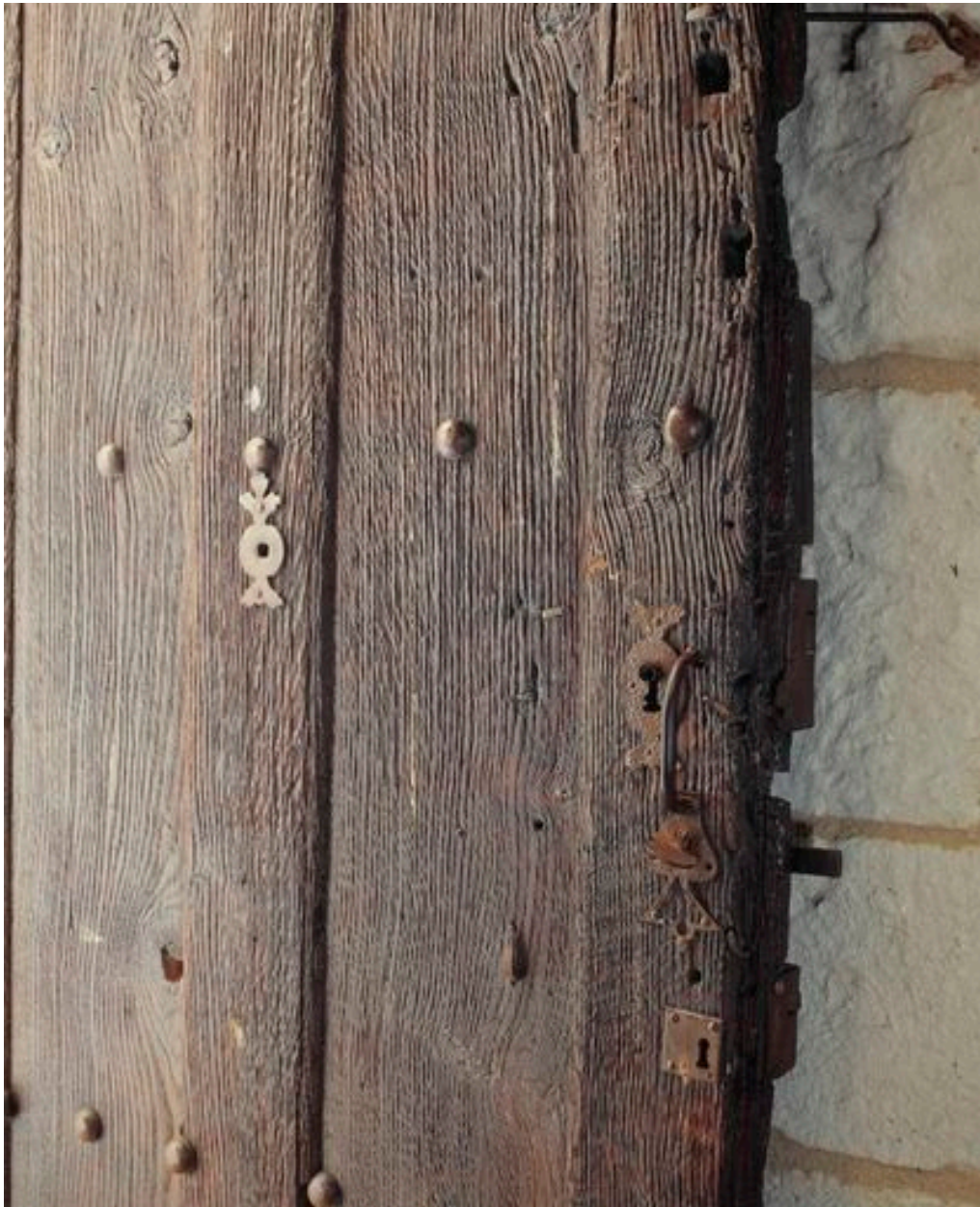
Huisseries (fin XVIIe ou XVIIIe siècle ?). Entrée sur rue, porte bâtarde, revers sous le passage couvert, détail des ferrures et serrure (3).
