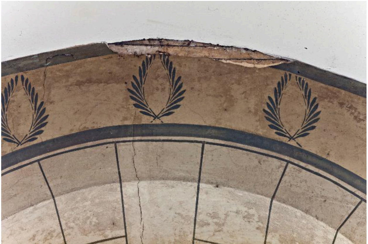
Bras nord du transept, mur nord, le monument aux morts, détail : décollement de l'extrémité supérieure.
