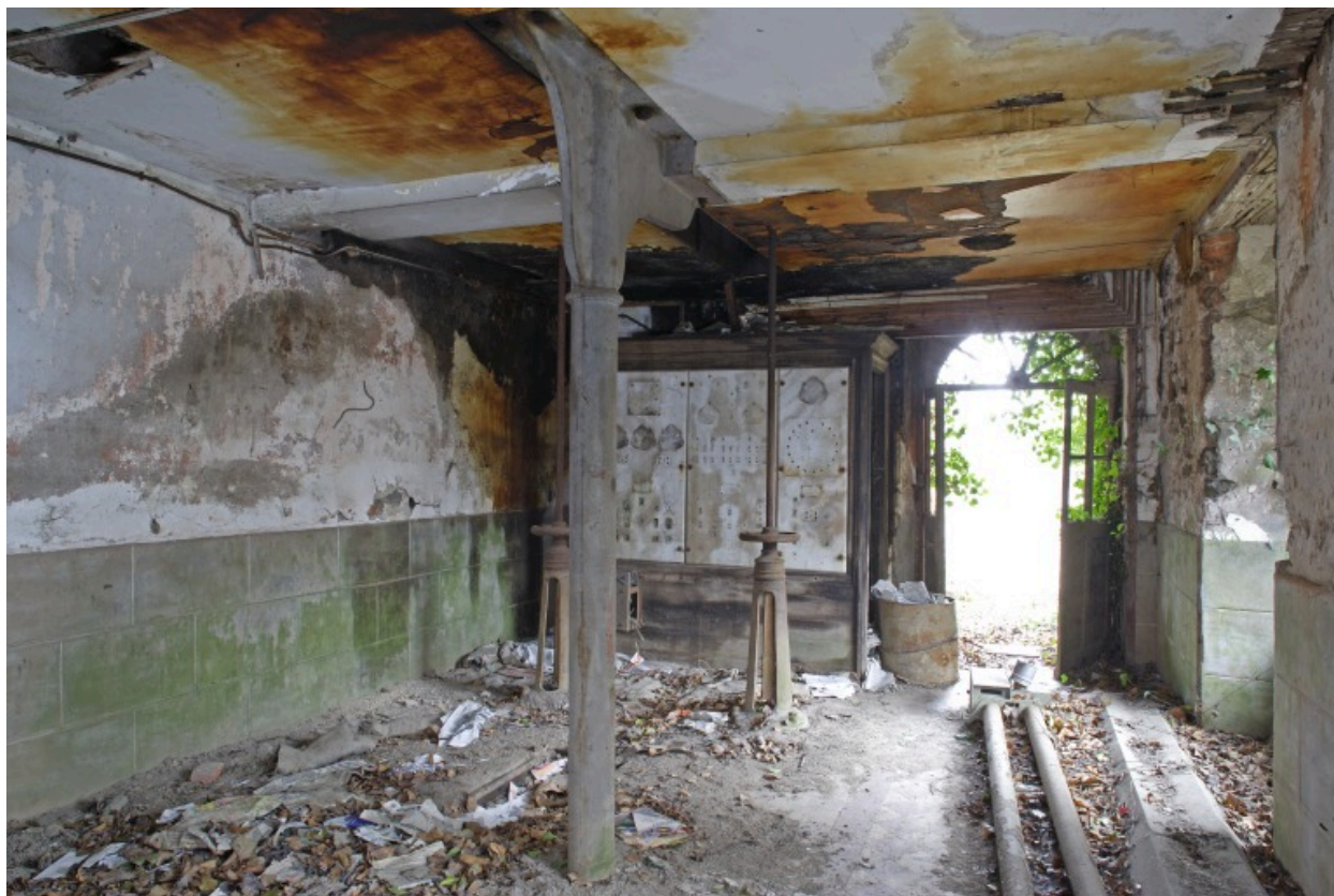
Le moulin à farine, rez-de-chaussée. La pièce ouest vue depuis le nord : au fond, le tableau de commande électrique.
