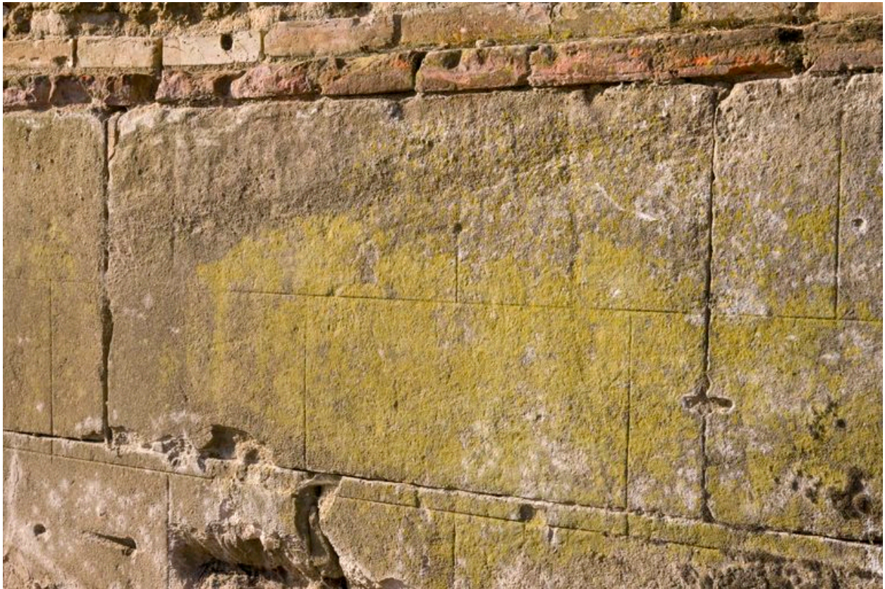
Détail du soubassement de pierre de taille de l'élévation antérieure de la grange-étable-fenil.
