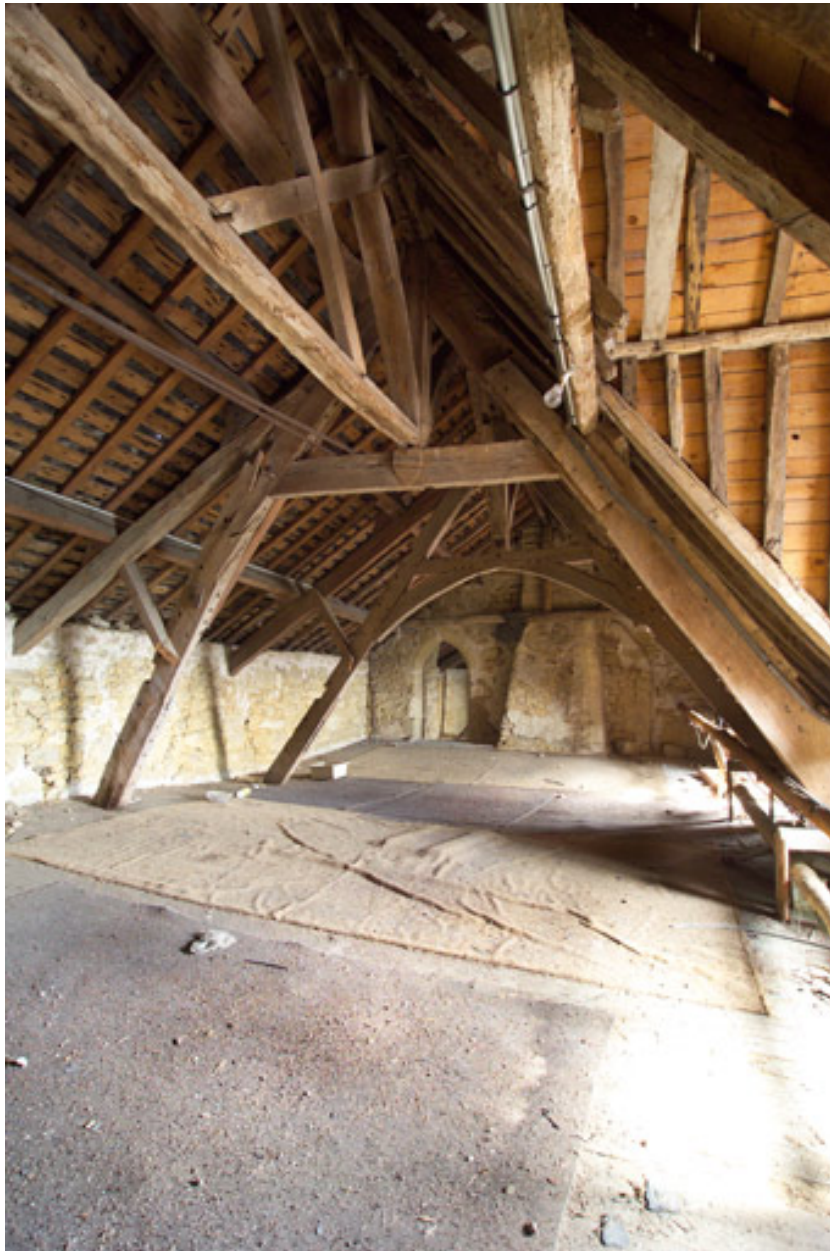
Vue d'ensemble (de tois-quarts) des charpente au-dessus de la grande pièce du logis.
