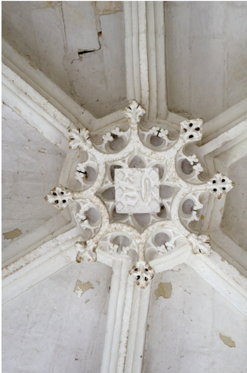
Ancienne chapelle nord (fin XVe siècle), étage. Voûte : clef sculptée aux armes des Chambes.
