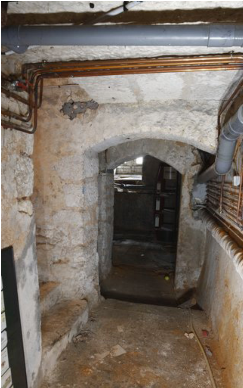
Sous-sol de la maison : vue prise vers l'escalier et la cuisine basse.
