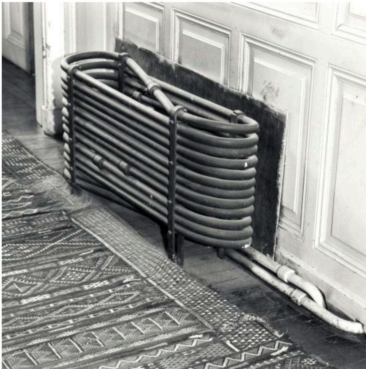
Vestibule, mur gauche : radiateur de chauffage central.
