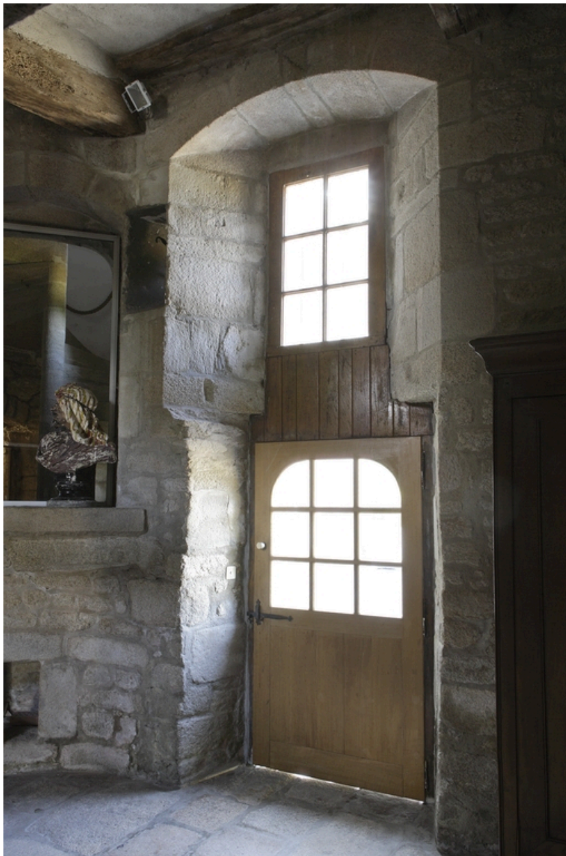
Logis. Aile nord. Rez-de-chaussée. Détail de l'embrasure de la fenêtre de la chambre et de la porte.
