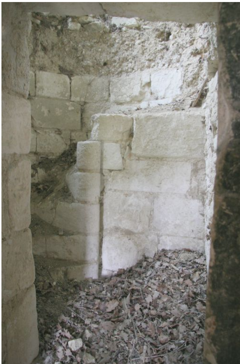
Ancien château, rez-de-chaussée : escalier en vis ruiné.
