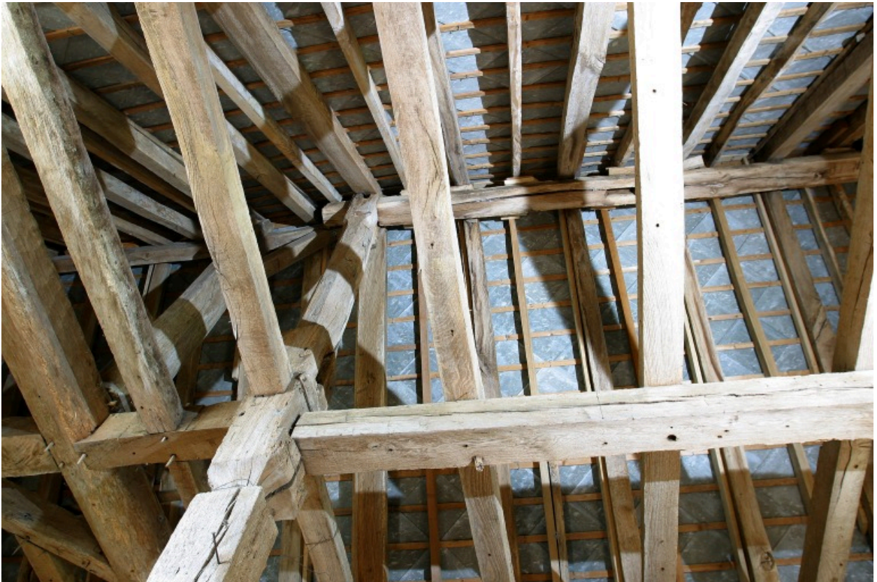
Comble. Détail de la charpente à la jonction de la partie ouest et de la partie est.
