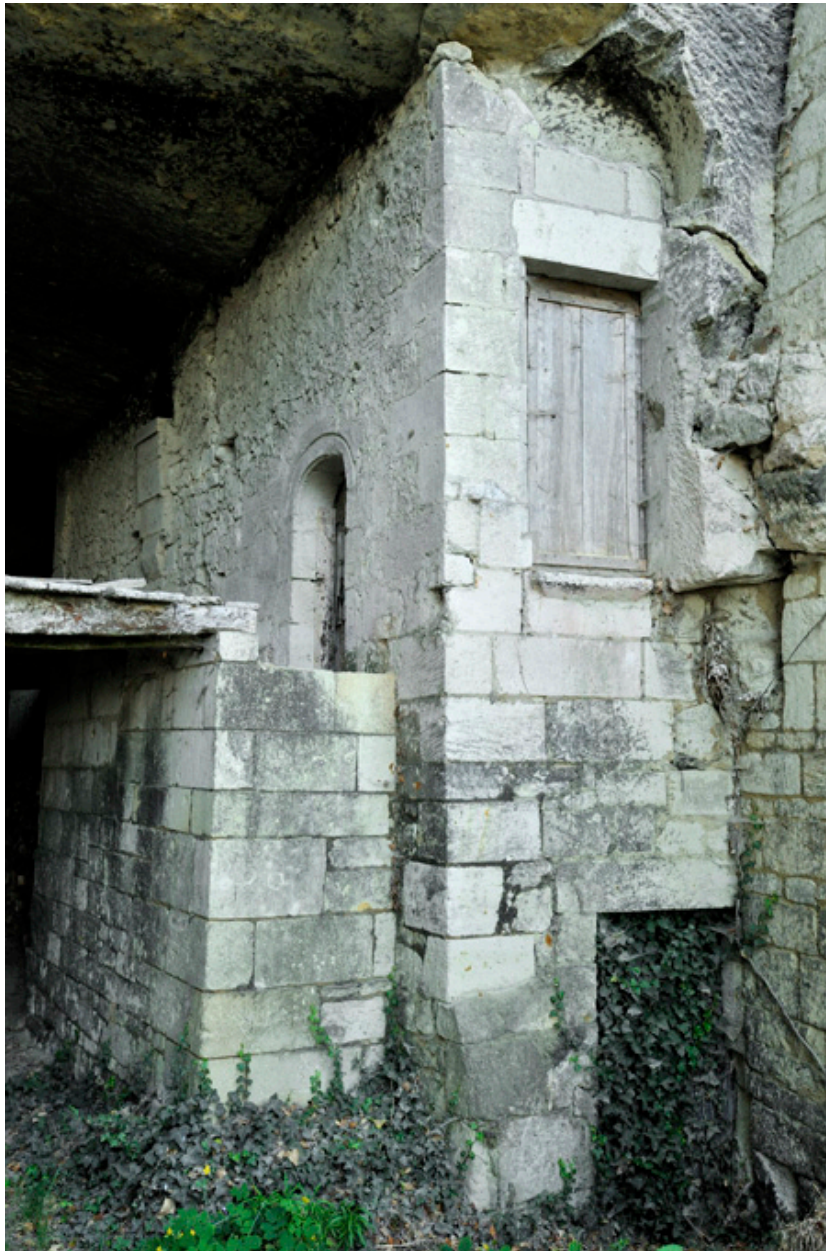
Site principal (11-16, ruelle des Perreyeurs). Entrée ouest de la carrière de la Maumènière, avec abris troglodytiques (éléments anciens du XVIIe ou XVIIIe siècle).
