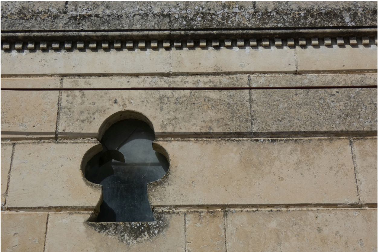
Détail : bandeau à denticules, assises de pierre à joints continus, baie en forme de trèfle.
