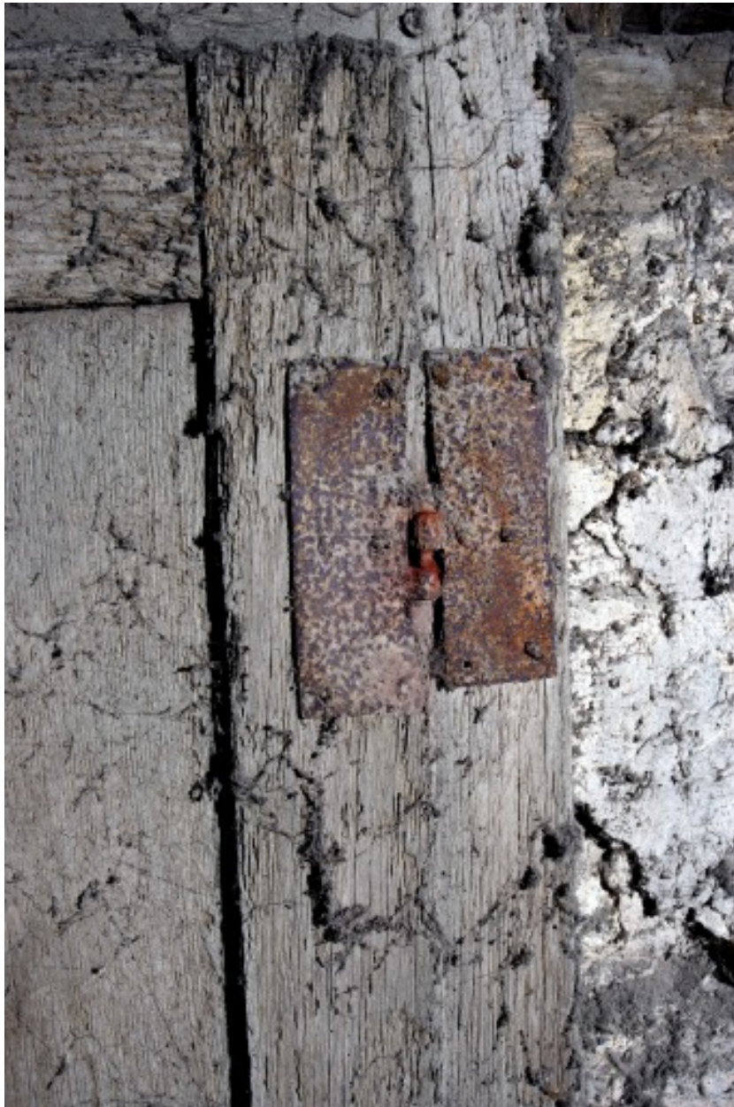
Comble de la cage d'escalier : la porte d'accès au comble de la partie nord, détail de la charnière supérieure.
