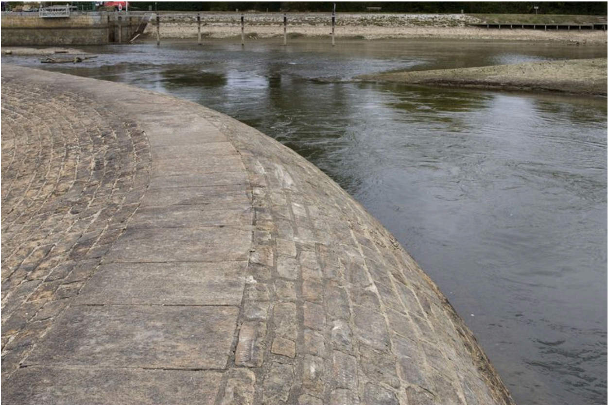
Vue partielle du barrage vers la rive droite, pendant les écourues de 2009.
