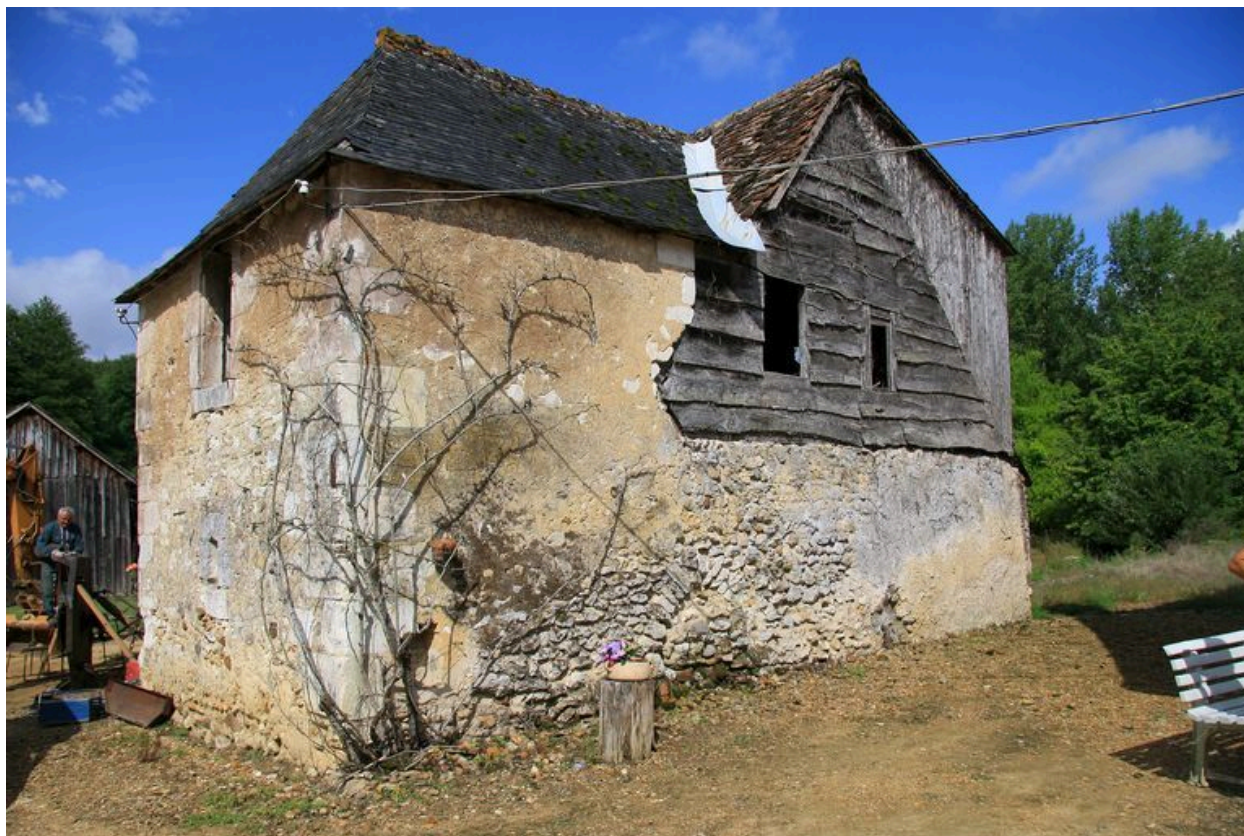
Le moulin, vue de volume : bief comblé, pignon en planches de la chambre des meules.
