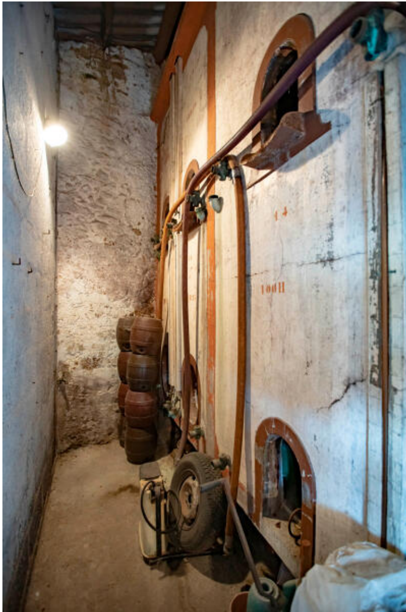
Cuves aériennes et leur couloir de service.
