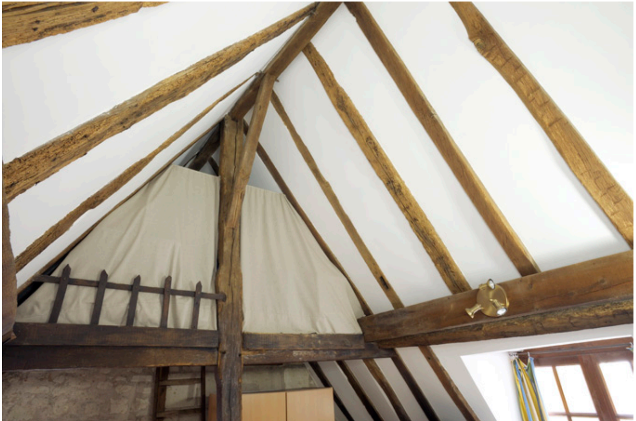
Comble : vue de la charpente, détail du poinçon nord et du contreventement.
