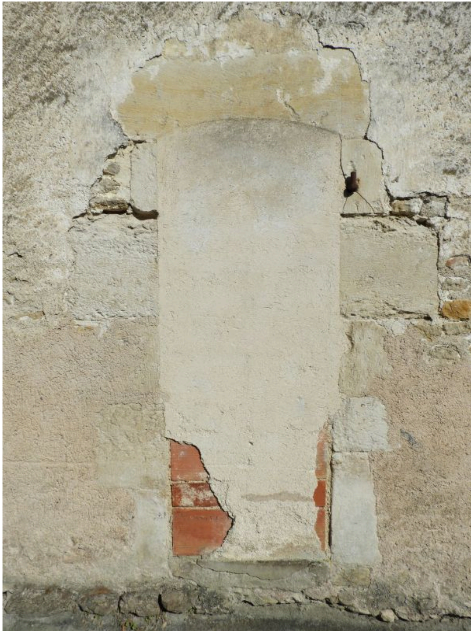
Vestige de baie à linteau en arc segmentaire sur le mur pignon de l'ancienne auberge, rue du Lion d'Or.
