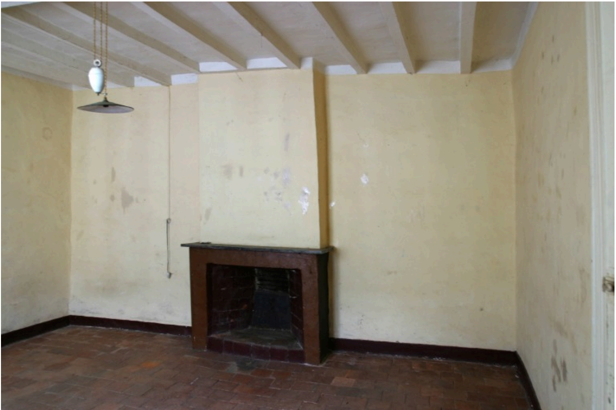
L'aile ouest, premier étage : la cheminée de la pièce située à l'extrémité nord.
