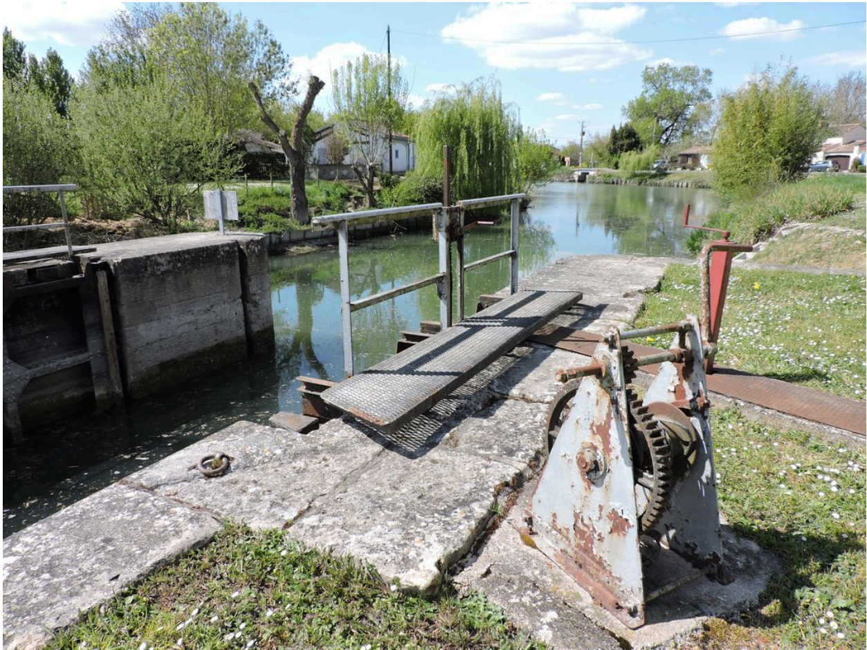
Mécanisme des portes de l'écluse du Mignon.
