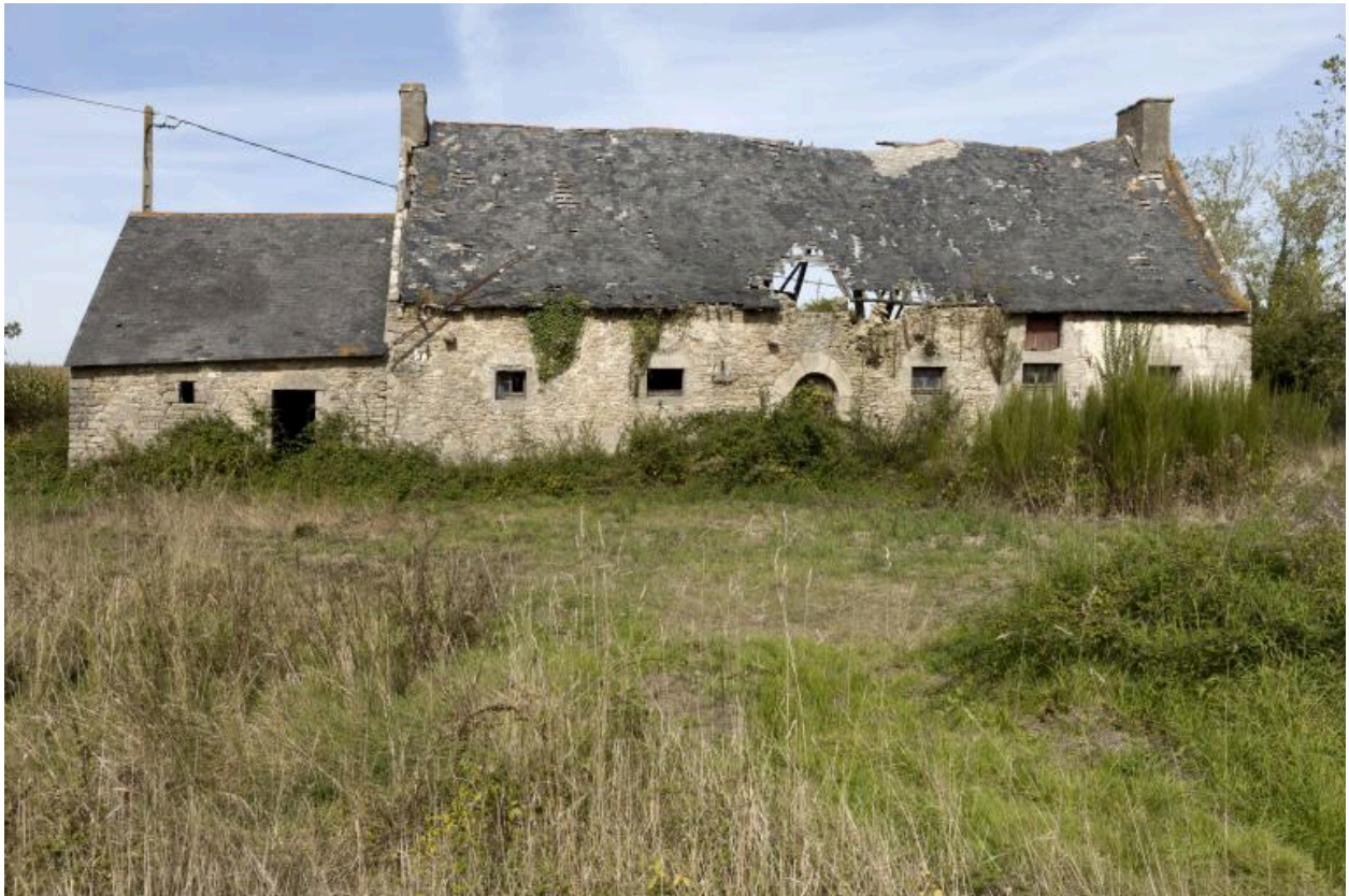
Bogat, élévation du bâtiment de la métairie du manoir, vue vers le nord.
