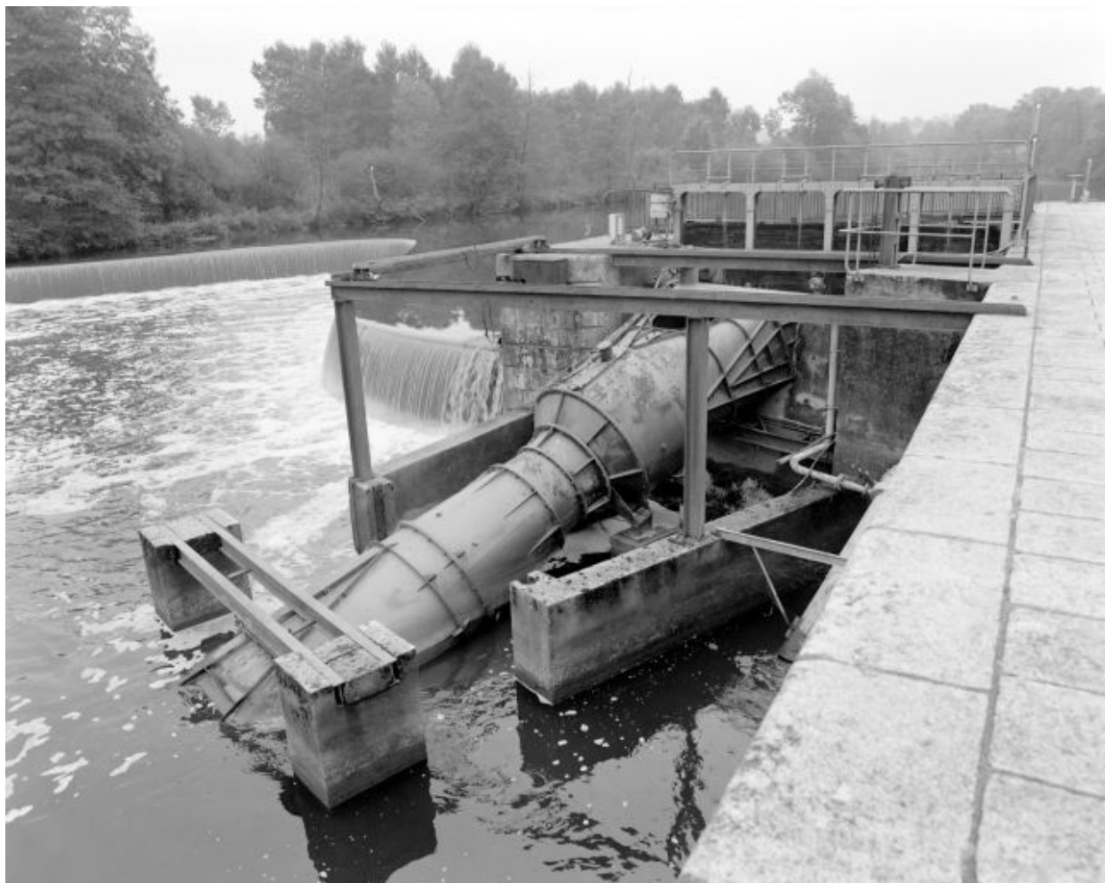
La micro-centrale électrique.
