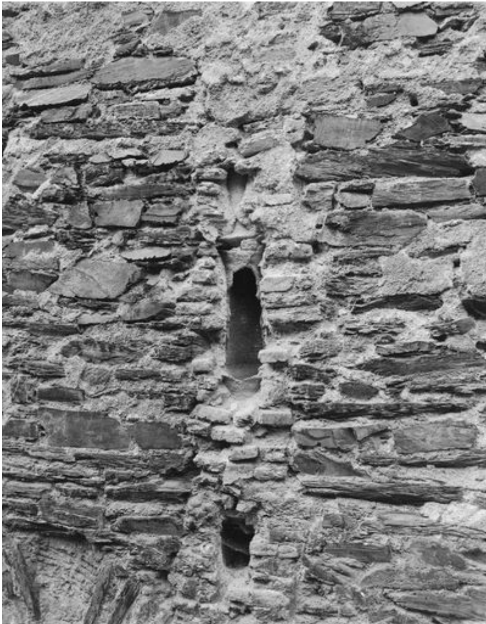
Vestige de l'aile orientale du cloître, élévation sur la rue Bonnetière : détails de maçonnerie et de canalisation.
