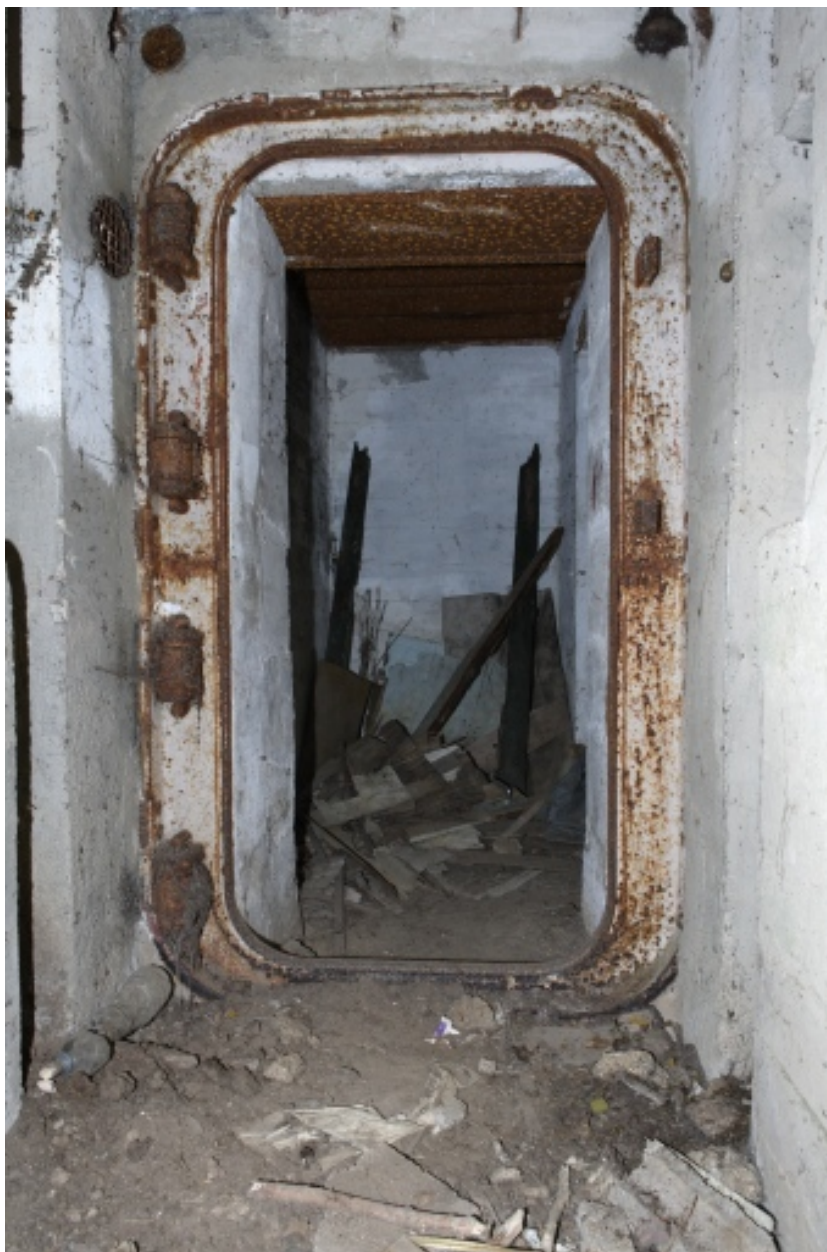
Détail de la porte blindée de la pièce principale.
